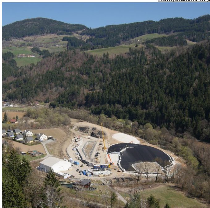
Figura 1. Sito contaminato K20; la zona I, sopra la maggior parte della quale è stata installata una copertura, si trova nella parte anteriore mentre la zona II si trova nella parte posteriore (Marzo 2017).
