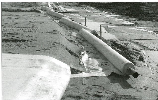
Abbildung 1: Ein Gewebe aus Polyester als Basisbewehrung beim Bau eines Erdwalls auf weichem Untergrund
