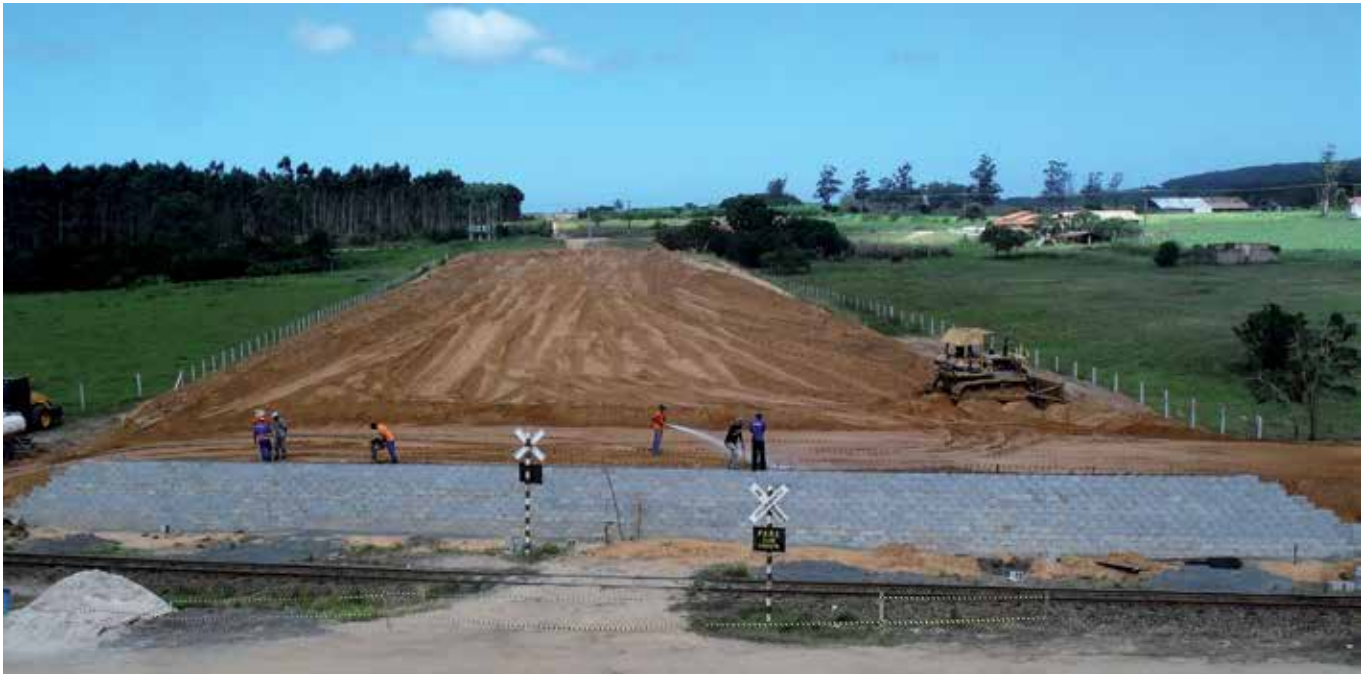
Figura 7 – Vista geral da obra com a face do muro em primeiro plano
