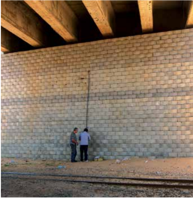
Figura 13 – Leitura das células de carga sendo efetuada com o muro e o viaduto já finalizados
