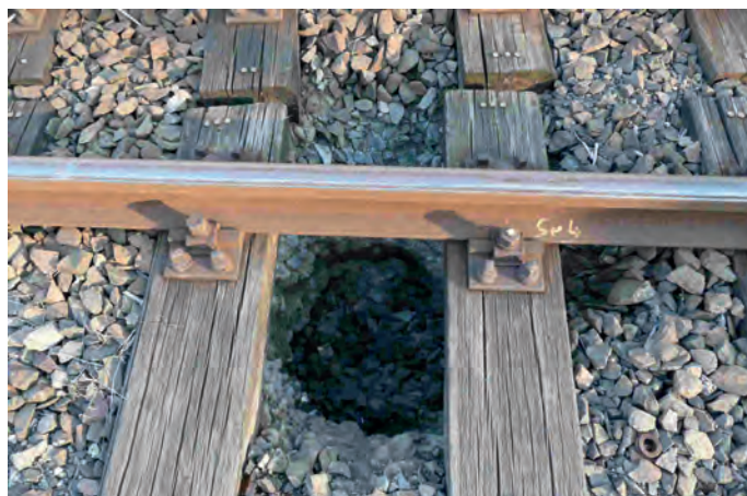
Abb. 2: Erdfall an der S-Bahn-Strecke Stuttgart - Kornthal
